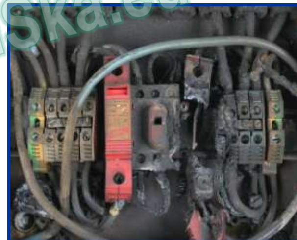
Zahoření způsobené špatným odpojovacím zařízením
